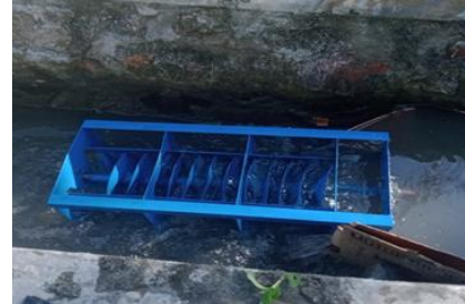
Gambar 6. Instalasi PLTMH dengan Turbin Spiral
